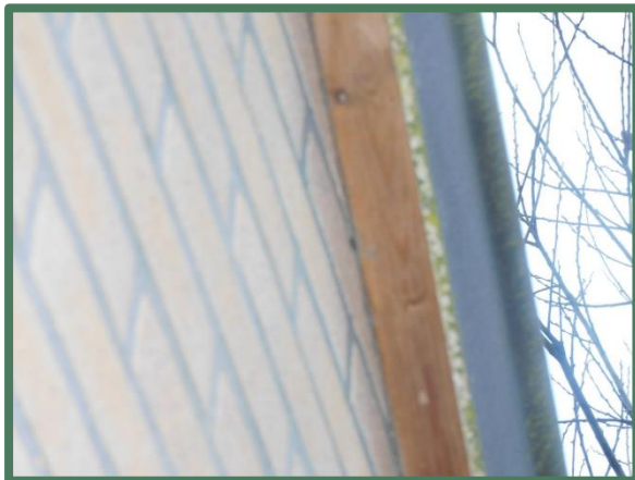
Bouwschuim en panlat onder de windveren loods
