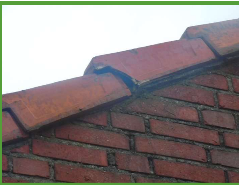
Mogelijke verblijfplaats van vleermuizen onder zijgevelpannen
