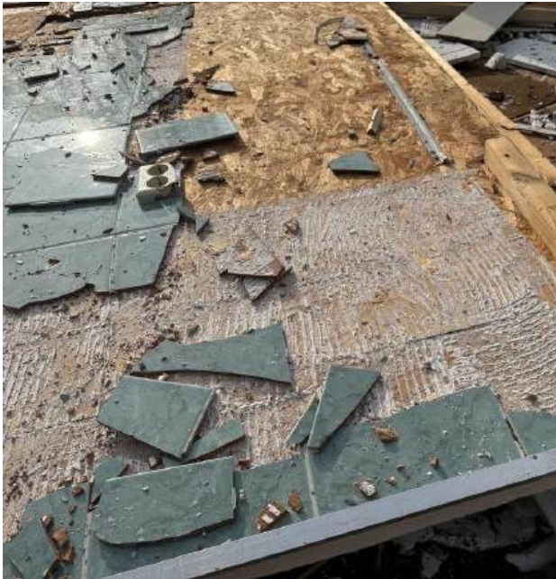
Foto 11 restanten terrein A, tegellijm niet verdacht, tegels van na 1994
