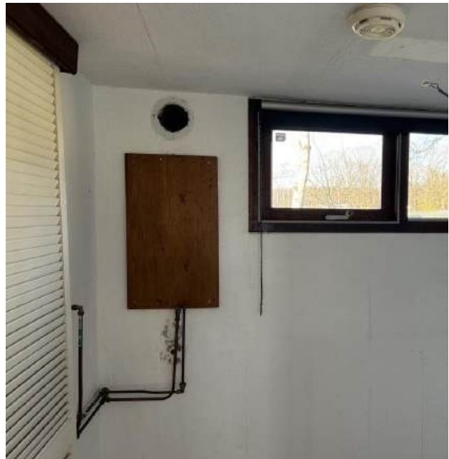
Foto 152 doorvoering niet verdacht, nr. 227
