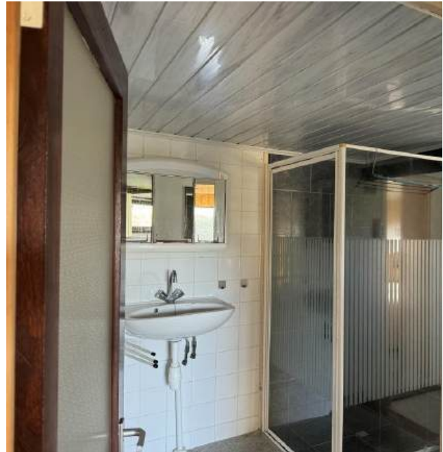
Foto 154 geen verdacht tegellijm
