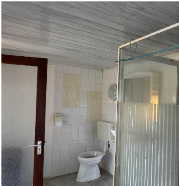
Foto 155 geen verdacht tegellijm
