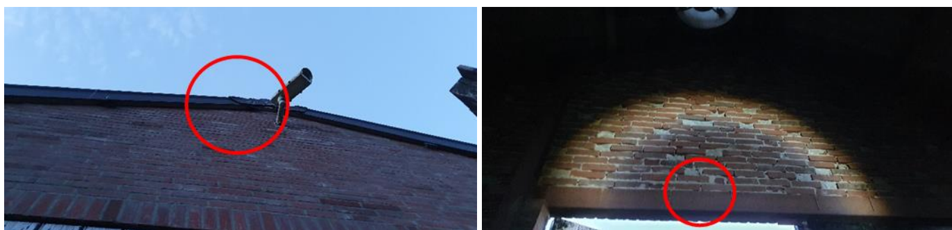
Figuur 4.7: In- en uitvlieglocatie van twee gewone dwergvleermuizen, één achter de daklijst/dakbetimmering en één net boven de U-balk. Dit is een zomerverblijfplaats van de gewone dwergvleermuizen.
