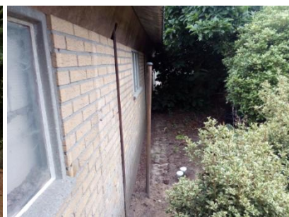
Ontluchtingspijp, tegen de gevel van de werktuigenloods.
