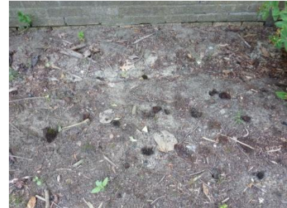
Mosdeeltjes op de bodem onder het golfplaten dak van de werktuigenloods.
