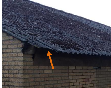
Beschadiging aan het asbesthoudend golfplaten dak van de werktuigenloods. Mos op de golfplaten.
