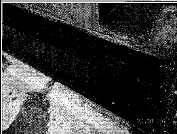
Foto 14: Plassen water in de mestput.
