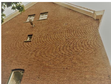
Stootvoegen in oostelijk kopgevel van hoofdgebouw
