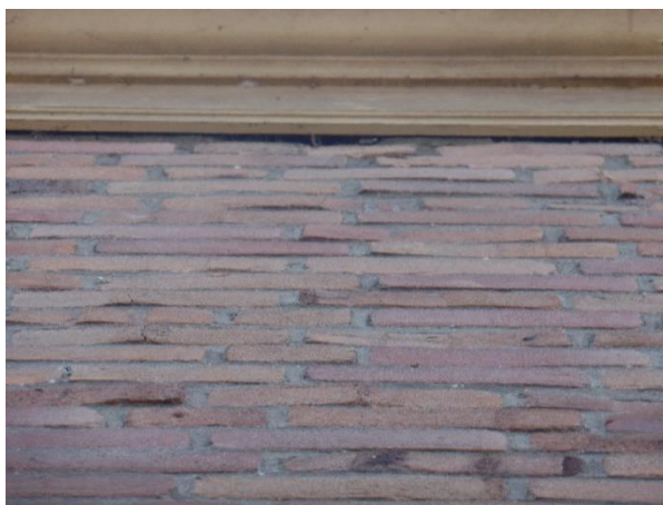
Kier tussen muur en houtwerk van bekisting
