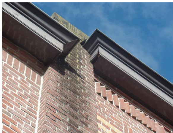
Beschadiging van bekisting
