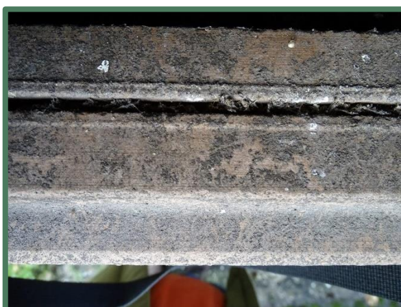
Gebrek aan ruimte tussen de betonplaten
