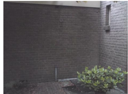
Ontluhtingspijp, naast kelderrooster.
