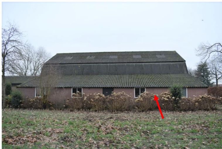
Linkerzijgevel, pijl geeft de naad in het metselwerk aan.
