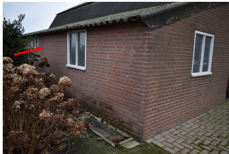
Rechterzijde van linkerzijgevel met rode pijl de naad in het metselwerk aangegeven.
