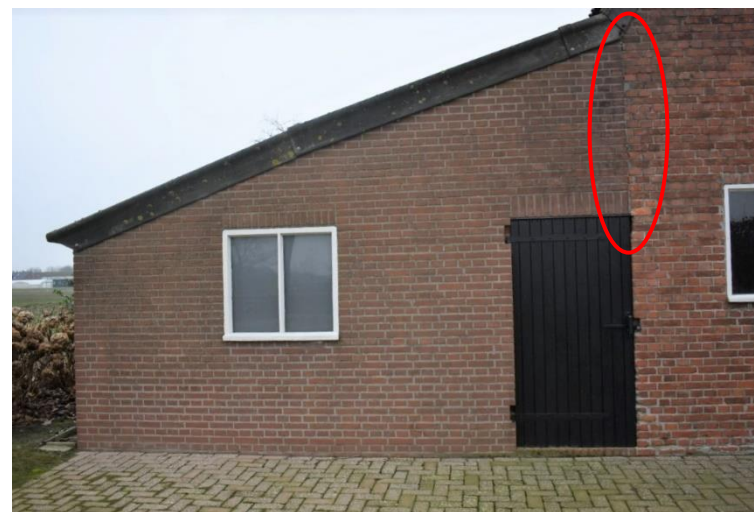
Voorgevel aanbouw aan linkerzijde (noordoostrichting) en onregelmatig aansluiting metselwerk (cirkel).
