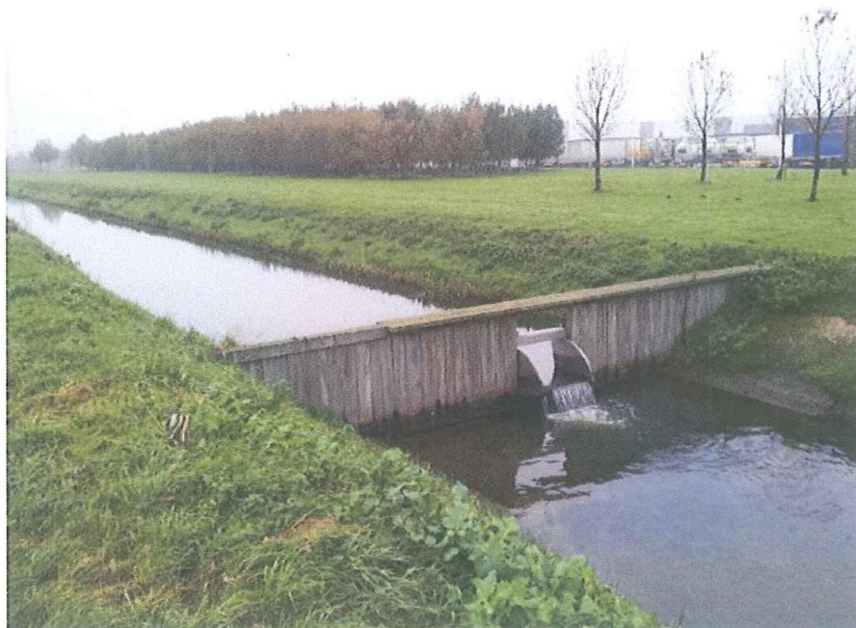
Afbeelding 3.2 Foto bestaande kantelstuw tussen peilgebieden
