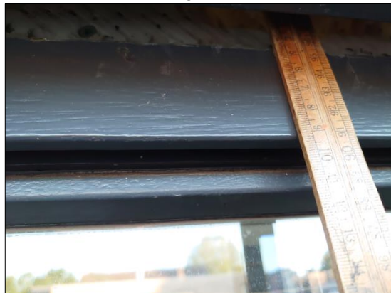
Foto 16: Detailfoto 2 grote spleet bij raamkozijn, diepte 4,5 cmv tot volledig isolatiepakket
