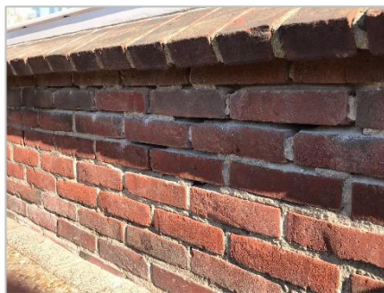
Foto 15: Voorkant woning met open stootvoegen en slecht voegwerk.
