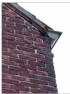
Foto 5: Duidelijk missende stenen op hoeken.
