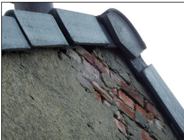
Figuur 9. Openingen onder overhangende dakpannen en de nok
