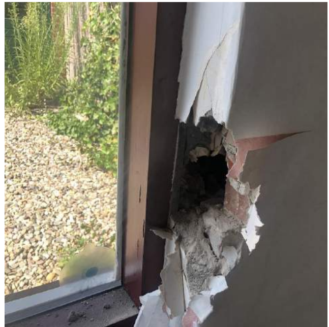
Impressie destructief onderzoek in de spouw.
