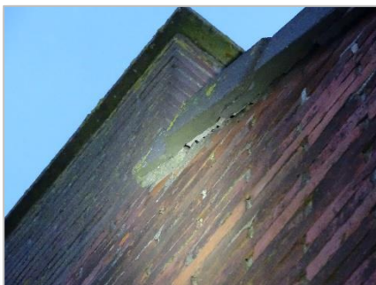
Foto 37: Openingen langs dakrand kopse kanten woningen.
