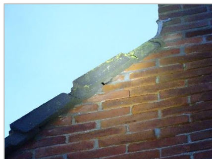
Foto 30: Openingen langs dakrand kopse kanten woningen.
