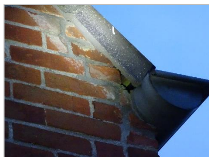
Foto 33: Openingen langs dakrand kopse kanten woningen.
