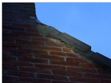
Foto 32: Openingen langs dakrand kopse kanten woningen.
