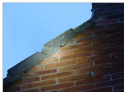
Foto 31: Openingen langs dakrand kopse kanten woningen.
