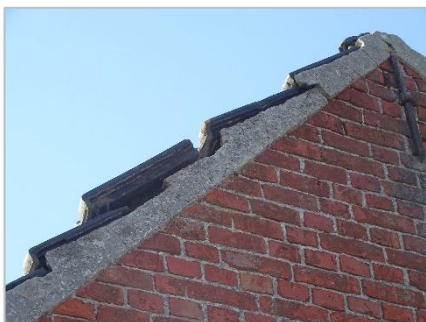
Foto 26: Scheef liggende dakpannen.
