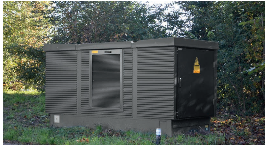
Afbeelding 11. Referentiebeeld transformator, Diabolo 5HL bron: alfen.com.
