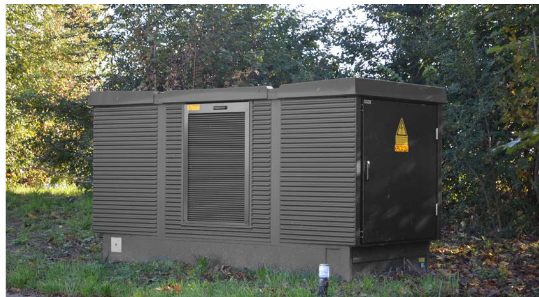
Afbeelding 8. Referentiebeeld transformator, Diabolo 5HL bron: alfen.com.
