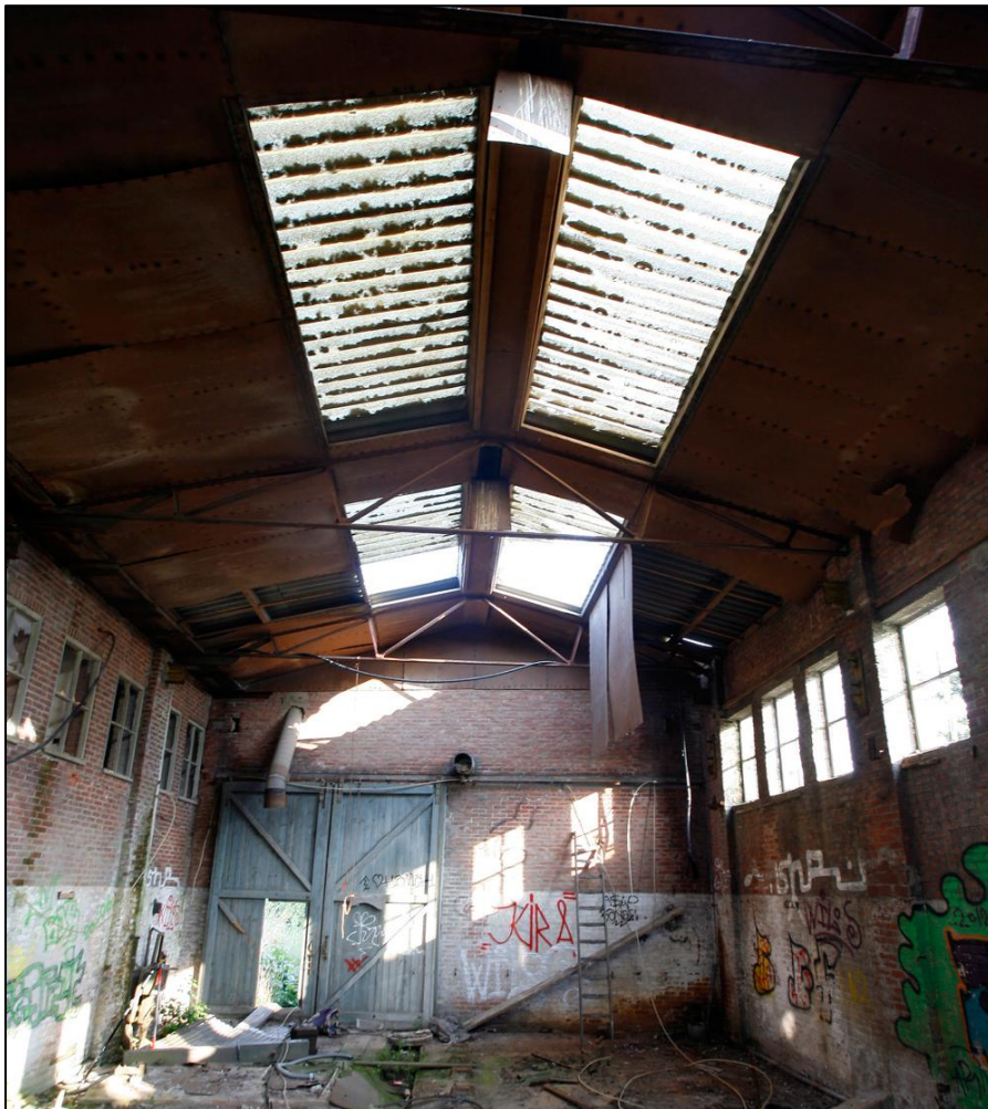
Figuur 12. Hal 3 met dak met beplating. Uitwerpselen van kerkuil zichtbaar op platen en grond. Hier werden tevens braakballen gevonden.
