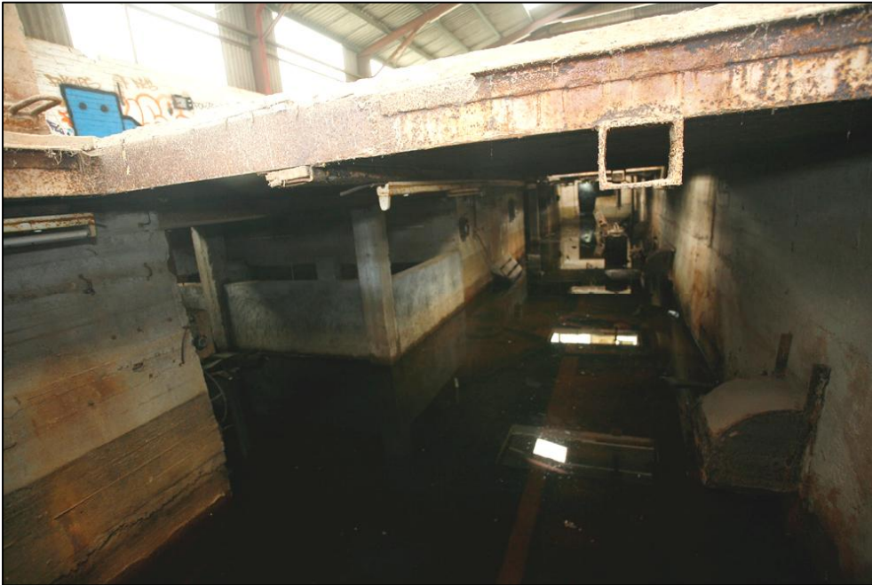
Figuur 10. Onder water staande kelder in hal 1.
