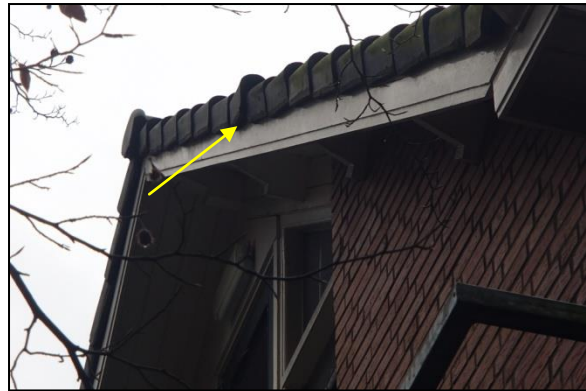
Figuur 16. Overhangende en losliggende dakpannen.
