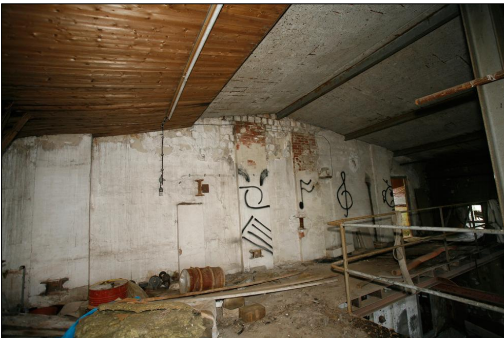
Figuur 11. Verdieping in hal 5. Bij de muur onder de daknok en onder de houten plafondbetimmering liggen keutels van grootoorvleermuizen en afgebeten vleugels van nachtvinders. Tevens de plek waar zwermende grootoorvleermuizen werden waargenomen.
