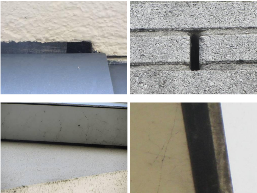
Afbeelding 5.4. Stootvoegen en spleten in het gebouw.
