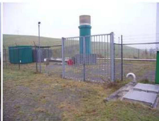
Huidige gasinstallatie: blower en fakkel
