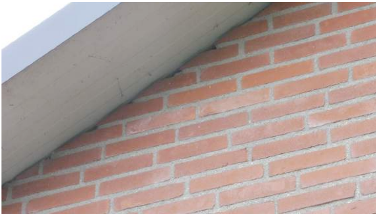
Afbeelding 9: Invliegopeningen tussen gevel en dakoverstek bij de schuur.
