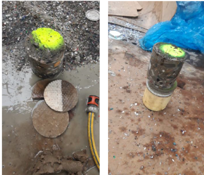
Figuur 3.1 Asbestverdachte isolatielaag
