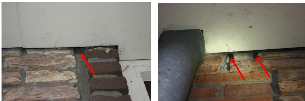
Figuur 4.2. Niet goed gevulde voegen die kleine zoogdieren toegang kunnen geven tot de bovenliggende gevelbetimmering (aangeduid met rode pijlen).
