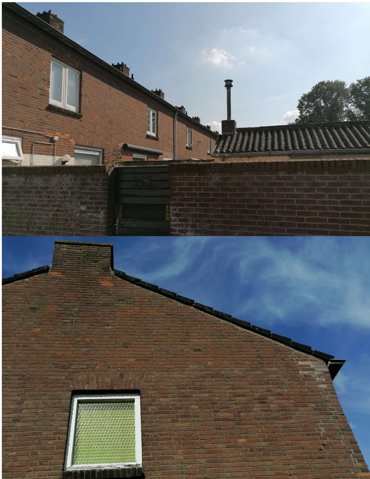
Boven: Achterzijde van de woningen. Geen spouwopeningen of openingen achter de dakgoot. Onder: Kopgevel. Openingen aanwezig onder de kantpannen.
