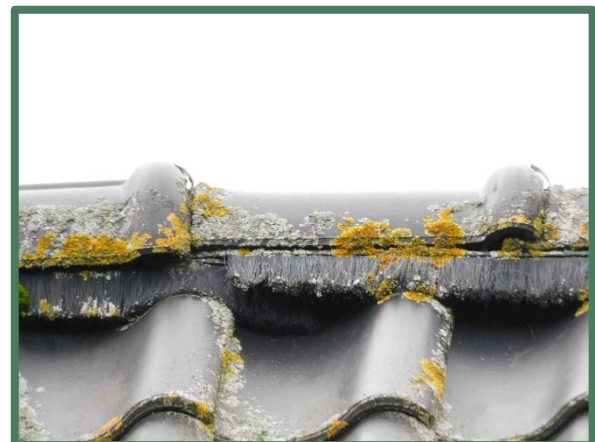
Weringsborstels onder de nokpannen
