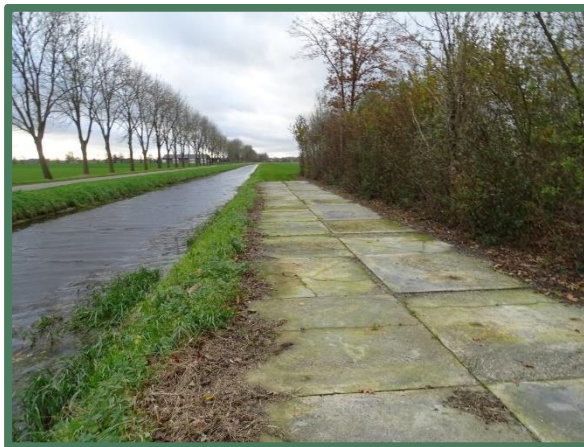
Betonplaten pad langs de Leij
