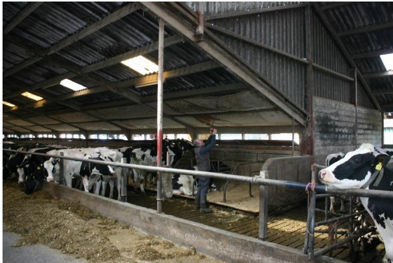
Figuur 4.4.7. Inspectie met boomcamera van de ruimte boven een verzakte plafondplaat in de grote koeienstal.
