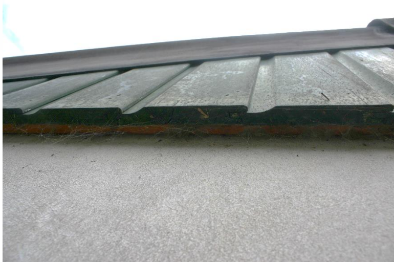
Figuur 4.4.6. De gevelbetimmering van de melkkamer kiert nergens.
