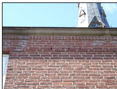
Figuur 27. Detailopname dakrand pastorie met open stootvoegen.
