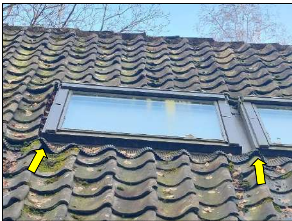
Figuur 18. Ruimte onder de loodflappen.
