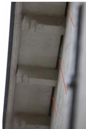
Figuur 5e: Potentiële doorgang tot ruimte tussen dakbeschot en pannen.
