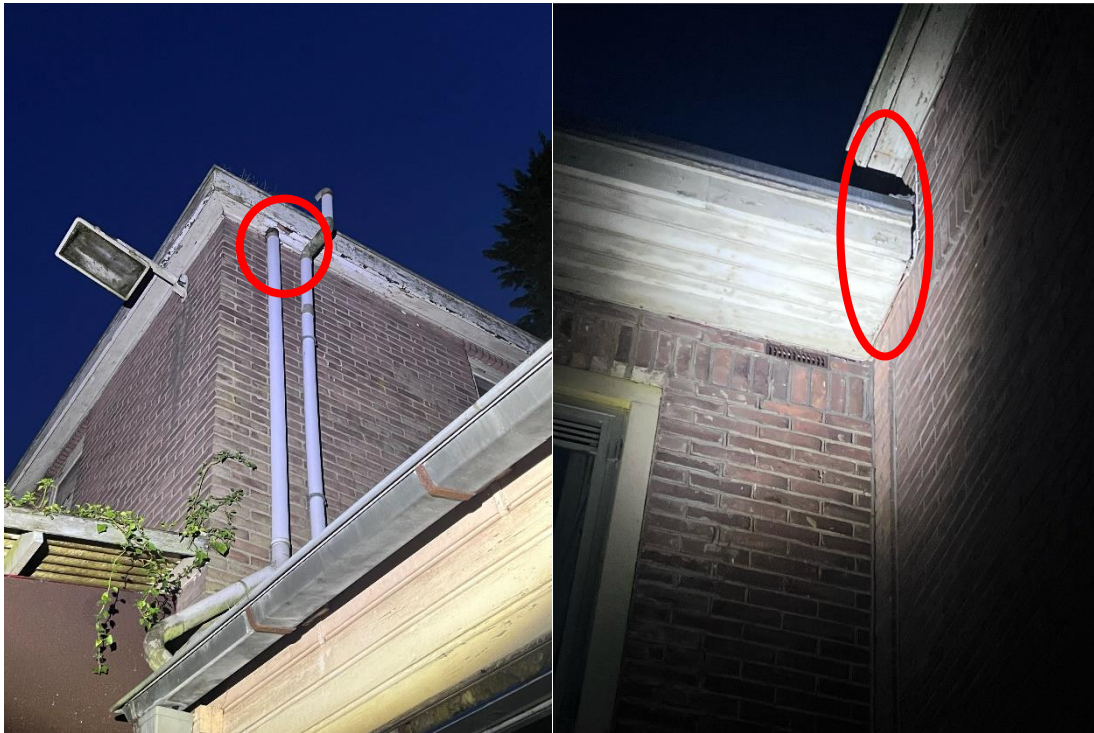
Afbeeldingen 1-3: Locatie van zomerverblijfplaatsen (rood) van gewone dwergvleermuis aan de achtergevel van het gebouw. Bron: A.F.S. Simons, datum: 04-10-2024
