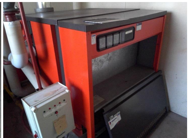
Foto 96 | Foto voor bron Cv-ketels
