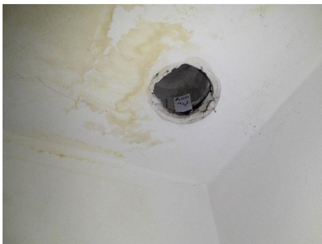
Foto 77 | Foto voor bron Ontluchtingsbuis
