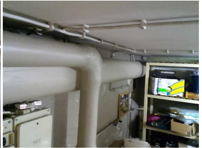
Foto 55 | Foto voor bron Leidingisolatie (Gips)
