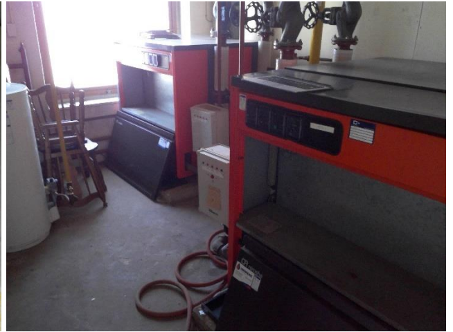
Foto 98 | Foto voor bron Cv-ketels
