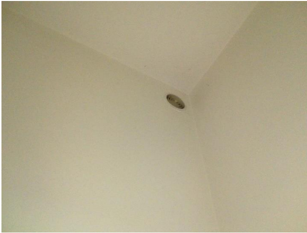
Foto 86 | Foto voor bron Ontluchtungsbus
