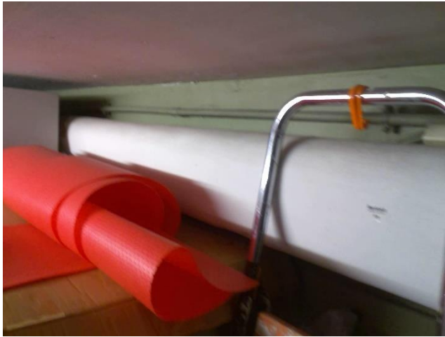
Foto 54 | Foto voor bron Leidingisolatie (Gips)
