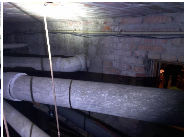
Foto 34 | Foto voor bron Ontluchtingsbuis
