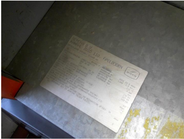
Foto 97 | Foto voor bron Cv-ketels
