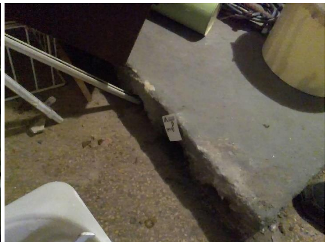
Foto 47 | Foto voor bron Ketelopstort (golfplaat)
