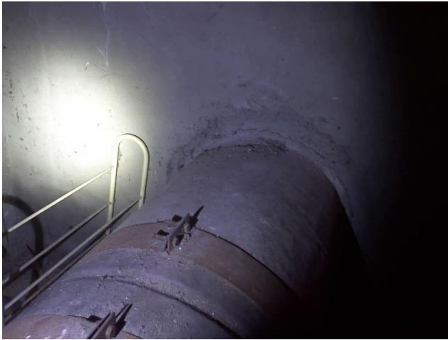
Foto 41 | Foto voor bron Ontluchtungsbus
