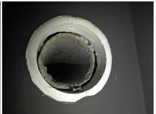
Foto 85 | Foto voor bron Ontluchtingsbuis
