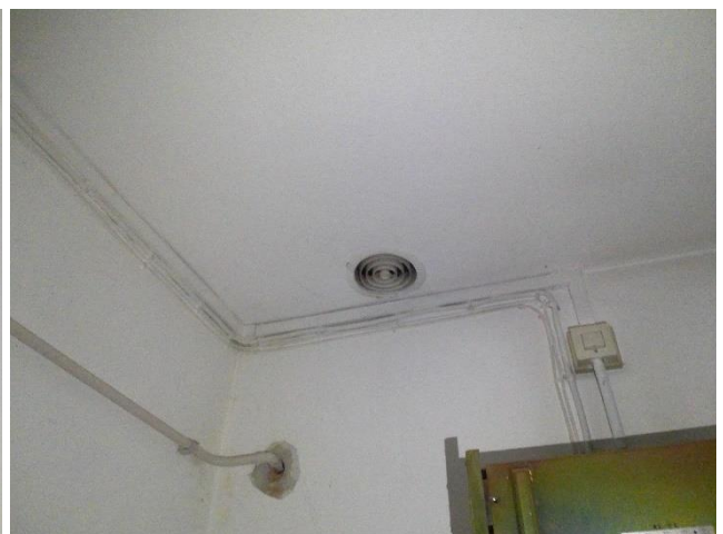
Foto 78 | Foto voor bron Ontluchtingsbuis
