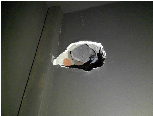
Foto 84 | Foto voor bron Ontluchtingsbuis
