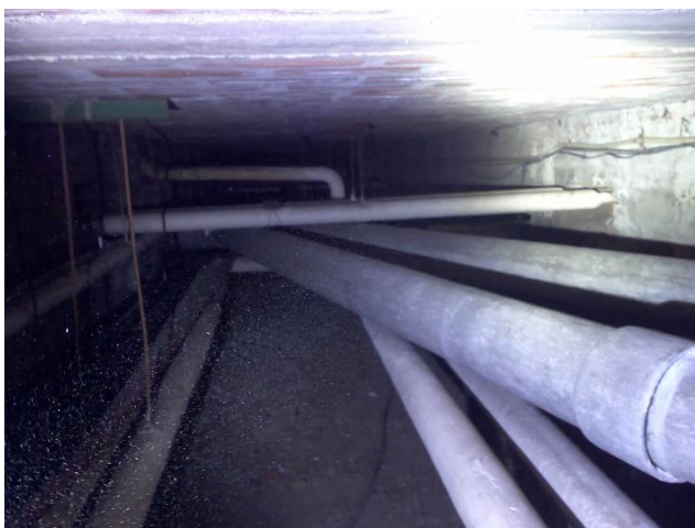
Foto 33 | Foto voor bron Ontluchtingsbuis
