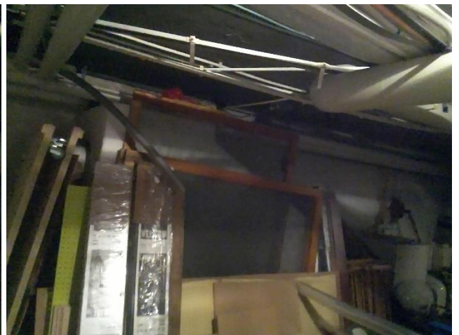
Foto 53 | Foto voor bron Leidingisolatie (Gips)
