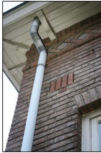
Foto 8. Verblijfplaats mogelijkheden voor gierzwaluw en vleermuis in winkelpand
