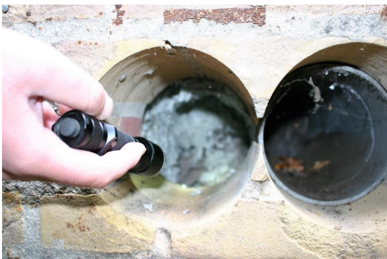
Figuur 20. De isolatiewol in de muur van zowel het verzorgingstehuis als de kapel drukt niet overal in de spouw tegen de buitenmuur, zodat er ruimte is voor vleermuisverblijven.
