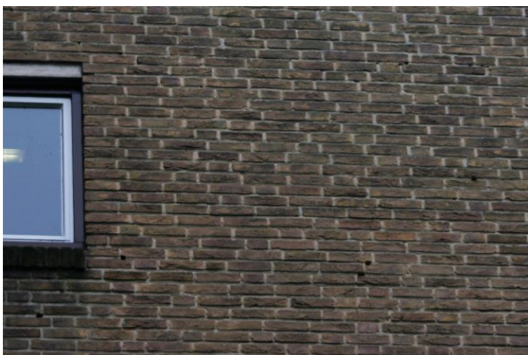
Figuur 19. Gaten in de muur geven vleermuizen toegang tot de spouw van het verzorgingstehuis.
