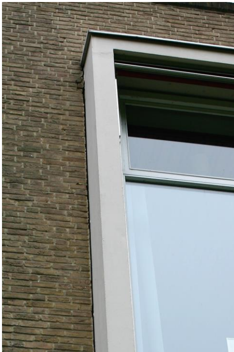
Figuur 17. Scheur naast een raam van het verzorgingstehuis geeft vleermuizen toegang tot de spouw.
