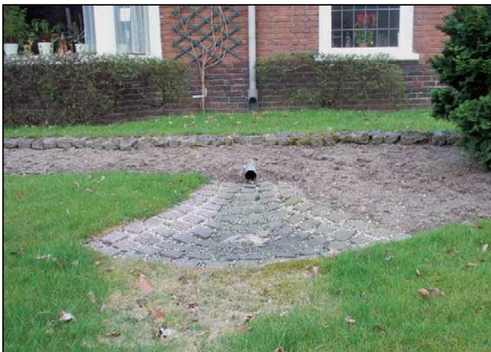
Figuur 15. Voorbeeld van een infiltratieveld.
