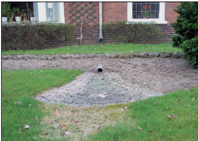
Figuur 15. Voorbeeld van een infiltratieveld.
