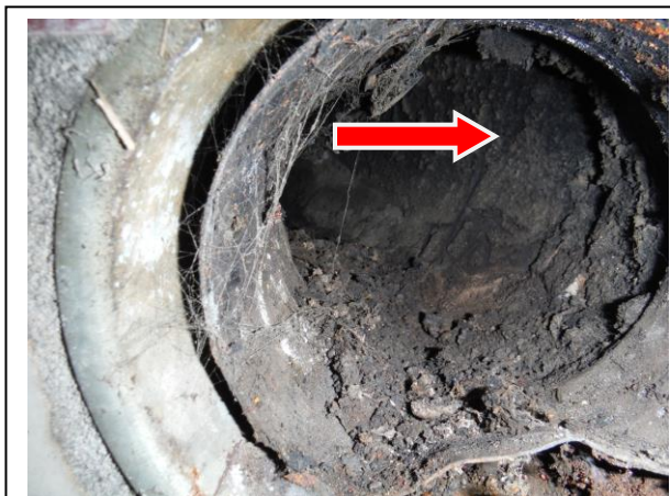
Foto 3: M3: Buis, rookgasafvoer
