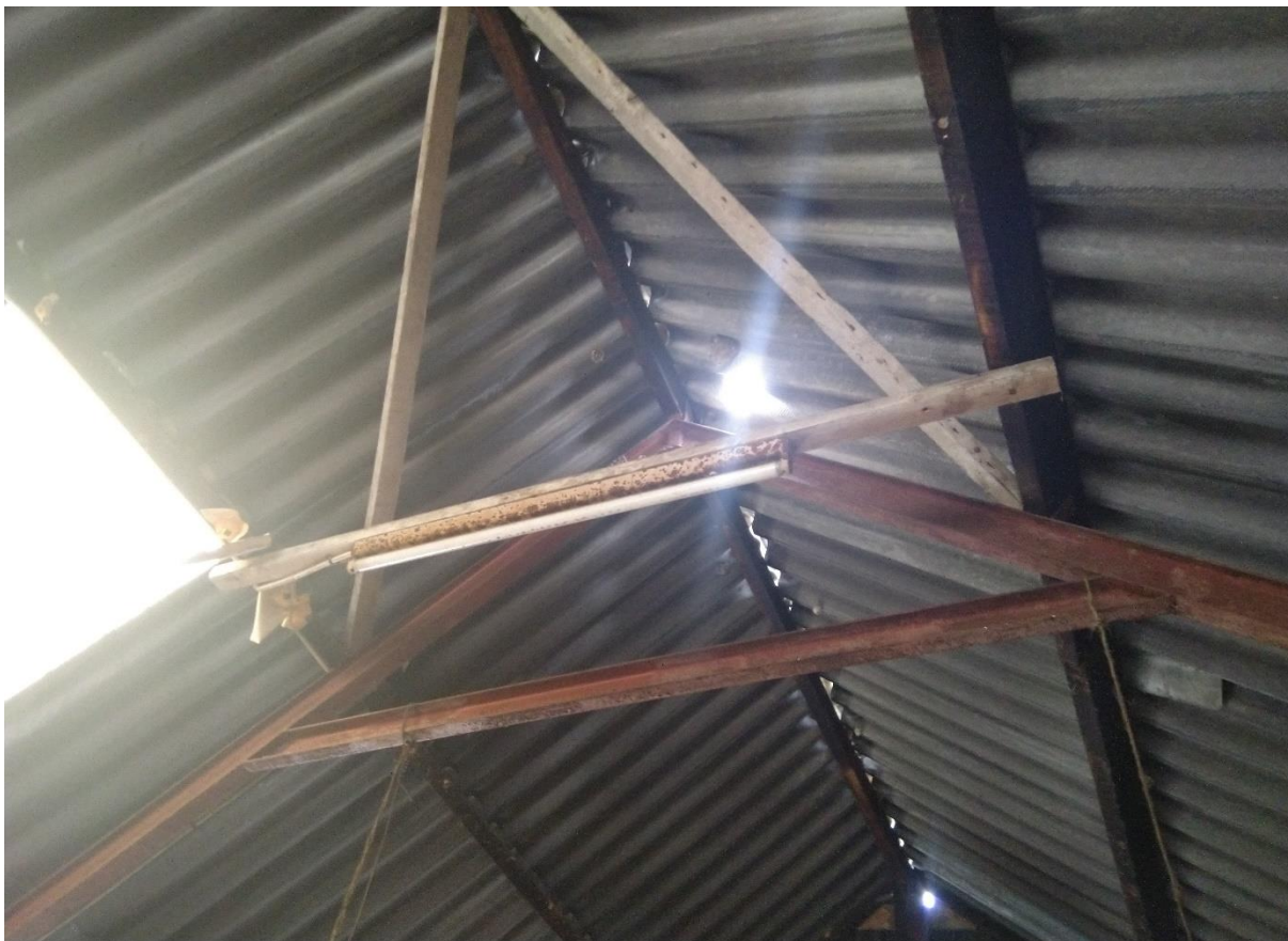
Foto 9: Gaten in het dak van de tuinschuur met linksboven het grote gat een wespennest.
