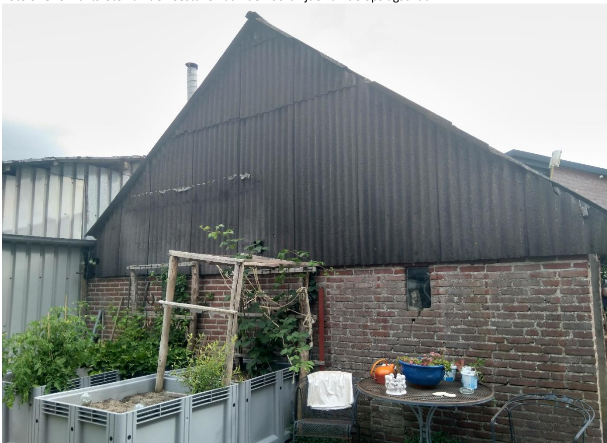
Foto 4: De zuidzijde van de tuinschuur met de afwerking van asbestplaten en scheuren in de gevel onder het raam.
