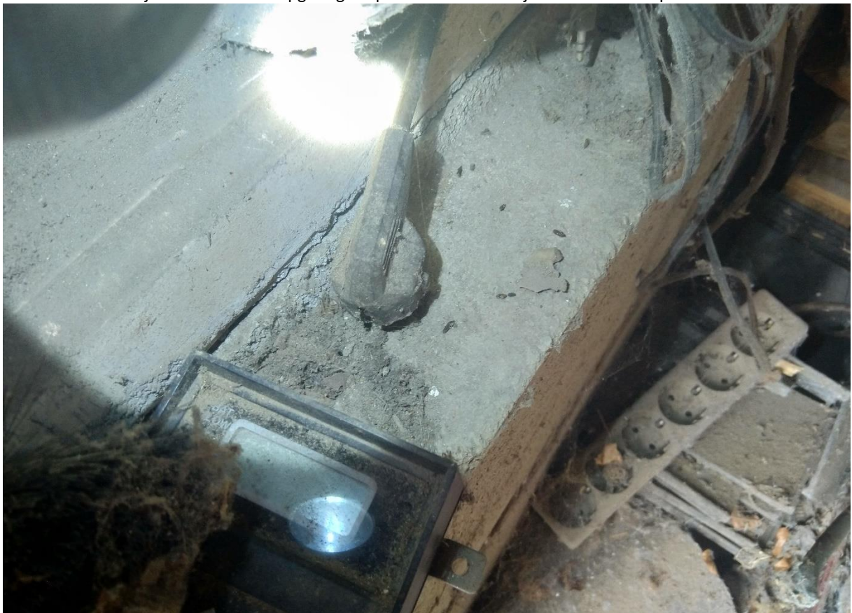
Foto 29: Ratten- of muizenfecaliën op een stukje muur in het zuidelijke deel van de kapschuur.
