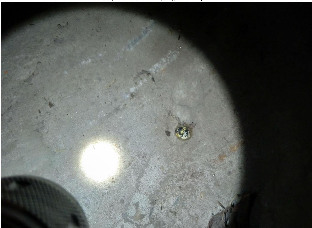
Foto 25: Vogelfecaliën op de grond in de noordelijke ruimte van de opslagschuur.
