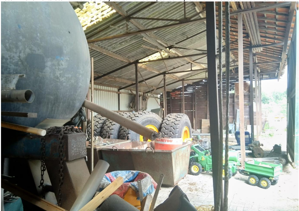
Foto 12: Overzichtsfoto van het noordelijke deel van de kapschuur kijkend vanaf het zuiden naar het noorden met het gedeeltelijk met asbestplaten en dakpannen bekleed dak zonder dakbeschoet.
