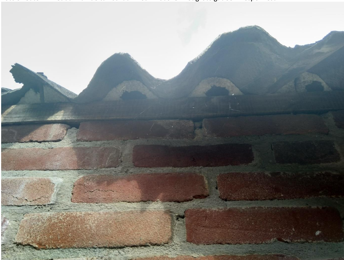
Foto 10: Wespennesten tussen de gevel en het dak aan de zuidzijde van de tuinschuur.
