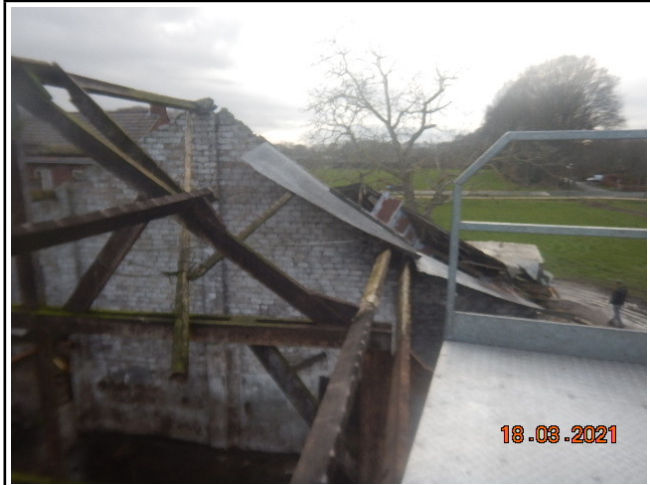
Foto 4. Verwijderde bron: B1.
