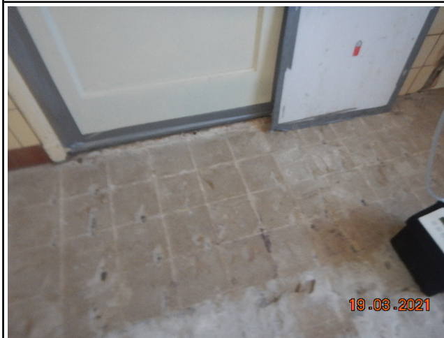
Foto 6. Verwijderde bron: B4.
