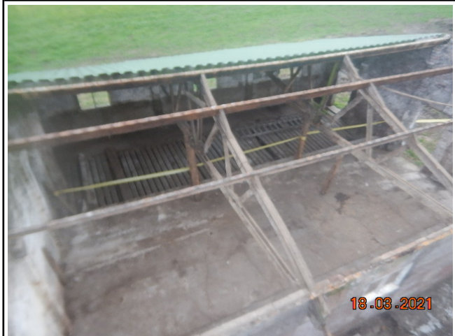
Foto 5. Verwijderde bron: B2.
