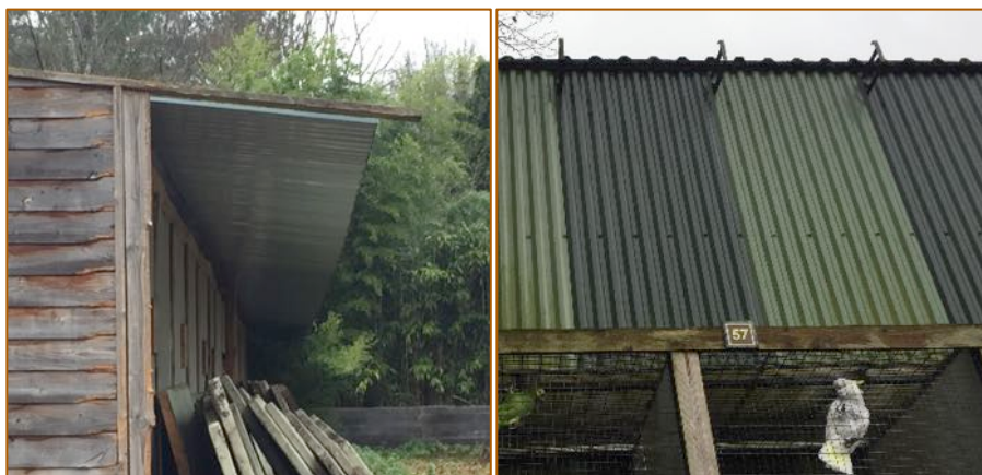
Afbeelding B: Daken zijn niet voorzien van goten.
