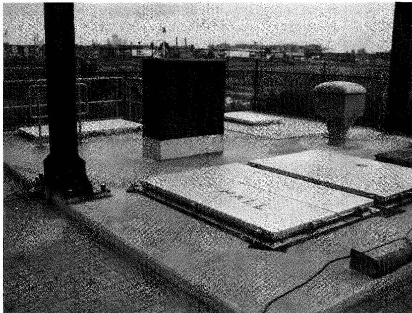
Figuur 3.5. Gemaal Doornhoek
