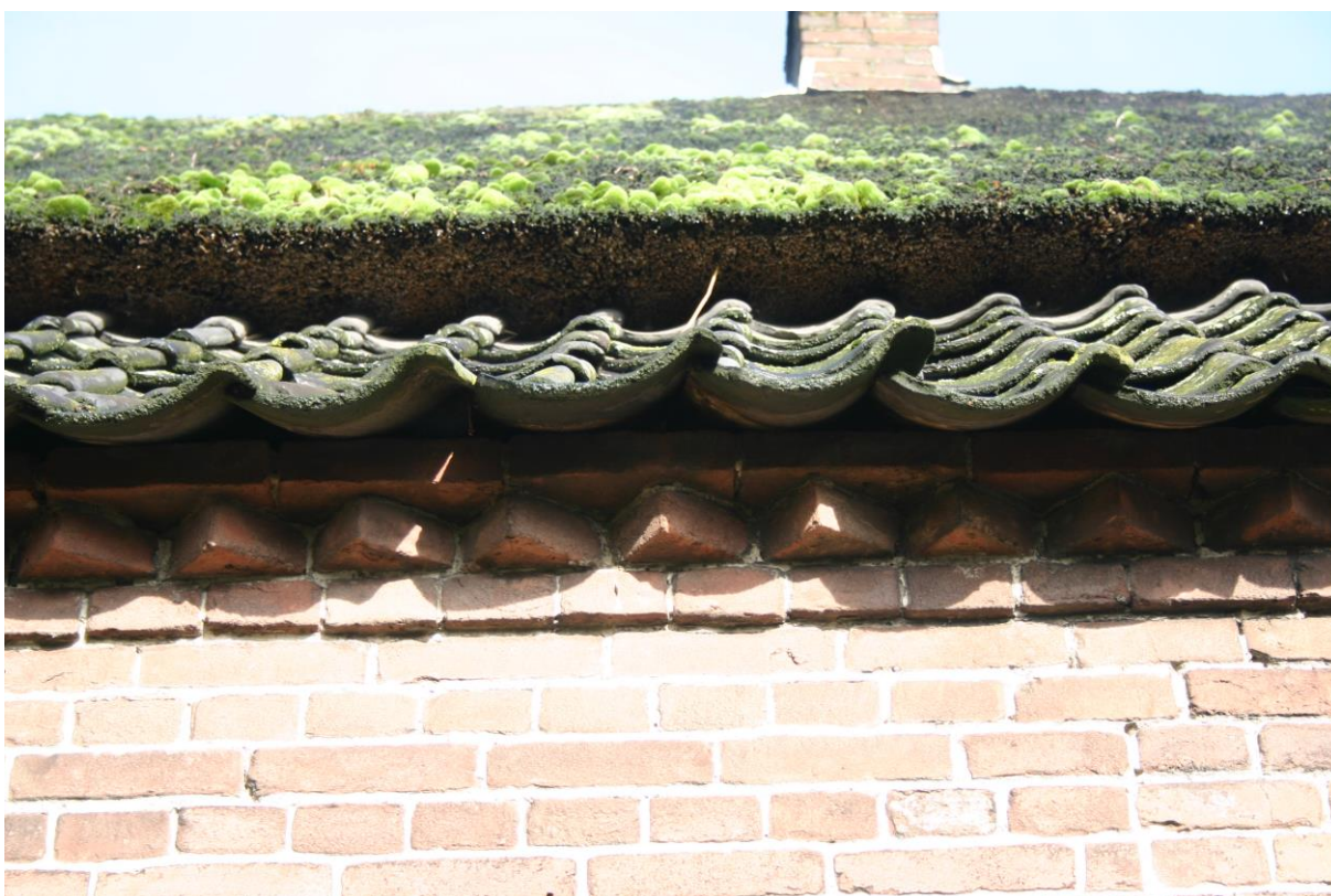
Figuur 7. Het woonhuis heeft geen dakgoten, waardoor vleermuizen makkelijk onder de onderste dakpannen kunnen kruipen.
