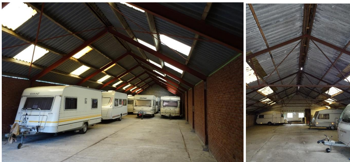
Afbeelding 7 en 8: Daken zonder dakbeschot. De aanwezigheid van huismussen is uitgesloten door het ontbreken van geschikte verblijfplaatsen. Bron: Rik Bijvelds Datum: 10-07-2020
