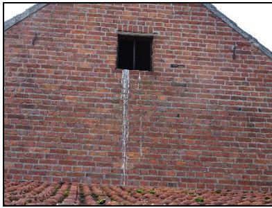
Figuur 10. Krijtsporen op de buitengevel van de schuur.
